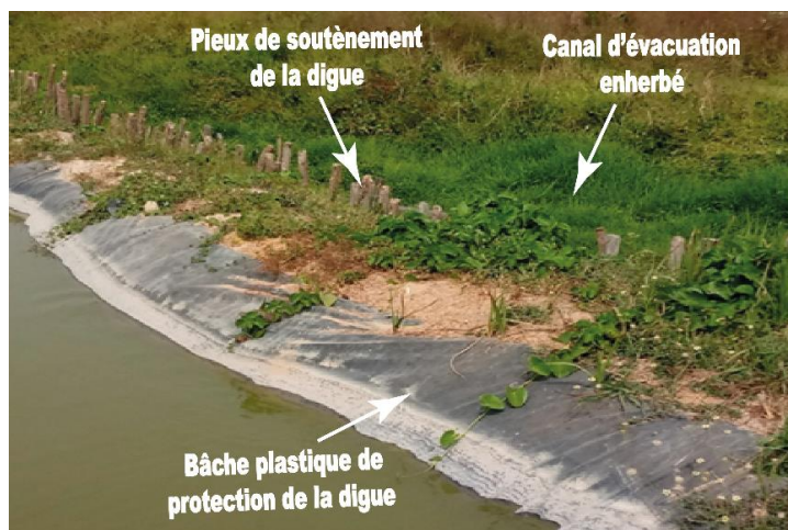
Photo 4: Usage de bâche plastique et de pieux de soutènement pour la stabilisation d'une digue « adossée » au canal d'évacuation
