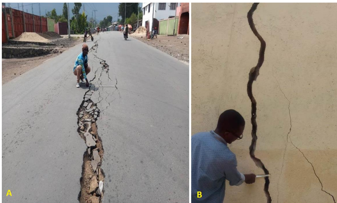
Fig. 9. (A) Fracturation de la route vers l'aéroport de Goma (B) Fissuration du mur d'une maison
