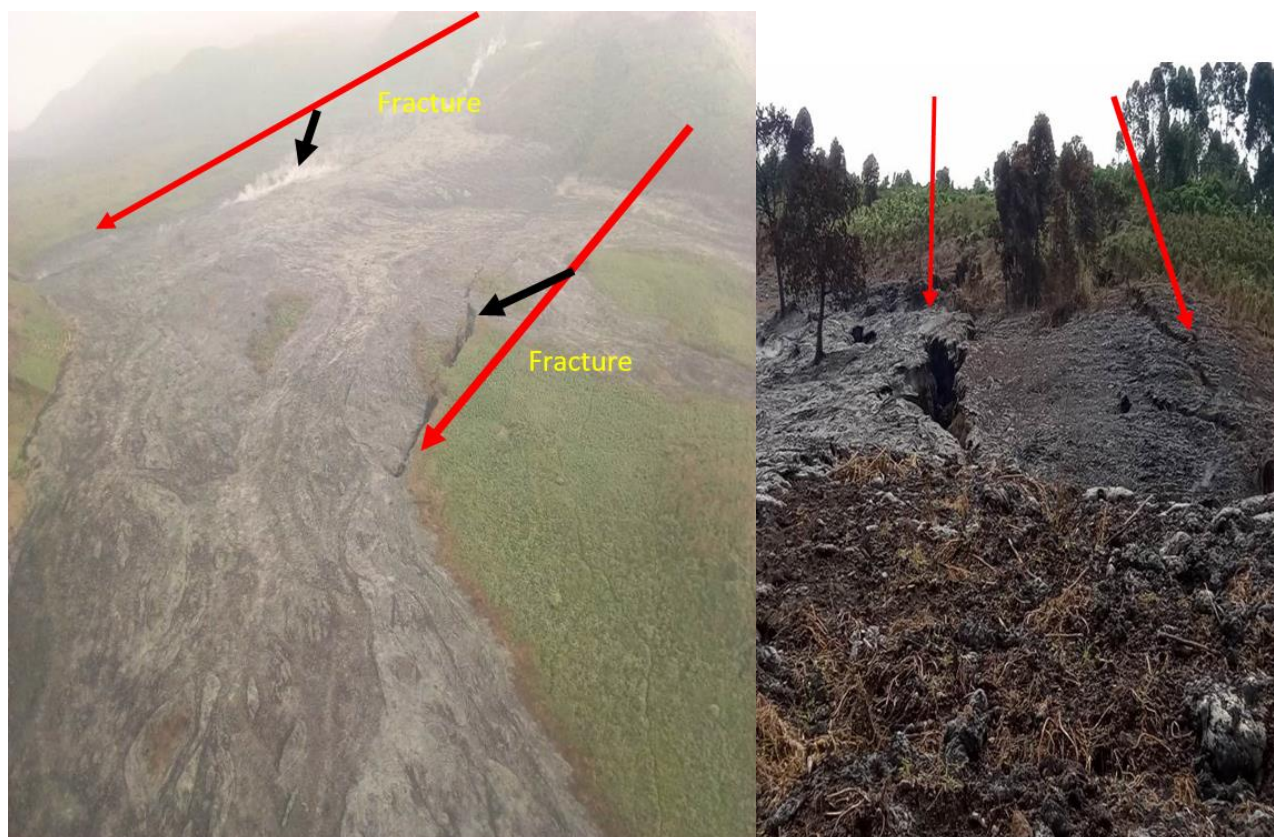
Fig. 5. (A) Fractures parallèles sur le cone de Butaka (Sud Shaheru) (B) Fractures parallèles au sud de Lemera
