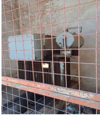
Fig. 1. Transformateur N°13 de la cité Gécamines
