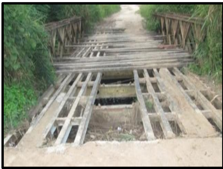
Photo 2. Vue montrant le pont métallique dégarni de traverses, de la rivière Fidi, sur la route Kisantu-Kimvula
