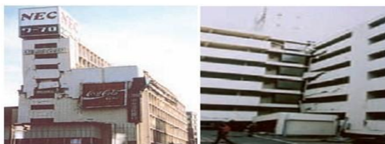
Fig. 5. Dommages dus à la présence des décrochements
