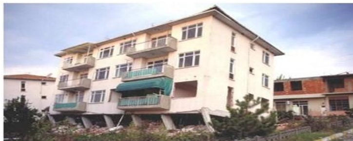
Fig. 3. Effondrement sous l'effet d'un rez-de-chaussée " souple "
