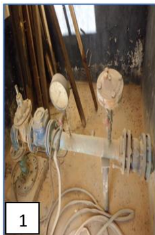
Photo1. Forage en panne
