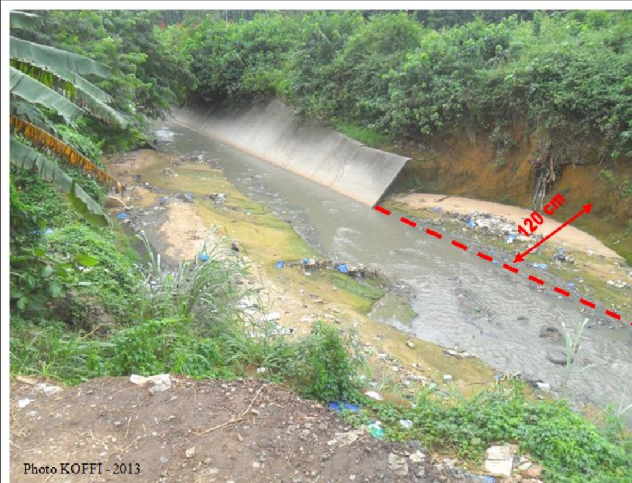
Photo 4 : Canal rompu aux flancs érodés – Carrefour Djeni Kobinan de Williamsville
