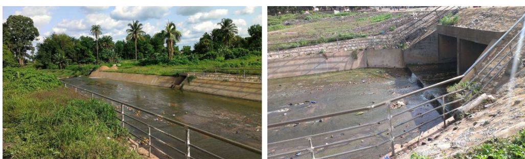
Planche 1 : Collecteur d'eau construit sur le site maraîcher de Sinangourou (partie inférieure à gauche et partie supérieure à droite)
