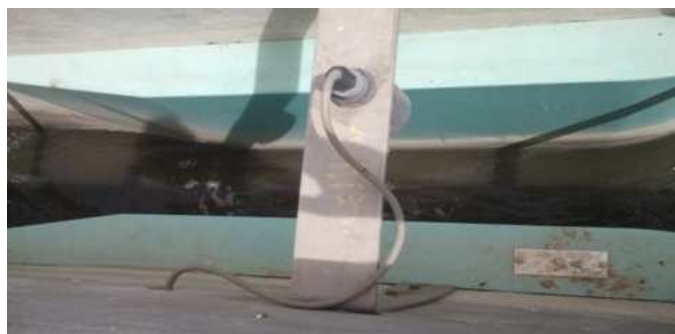
Fig. 3. Canal venturi de STEP Dar El Gueddari
