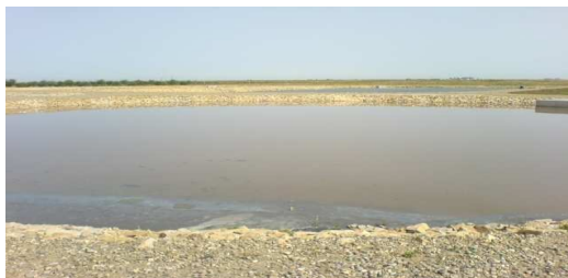
Fig. 1. Les bassins anaérobies de la STEP
