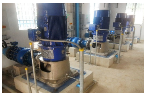
Fig. 2. Groupes motopompes du nouveau captage
