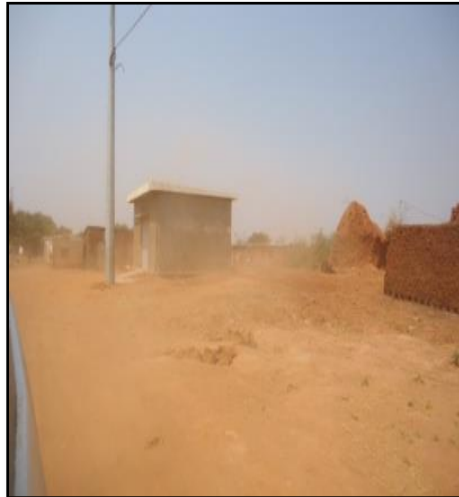
Fig. 2. Cabine électrique non fonctionnelle
