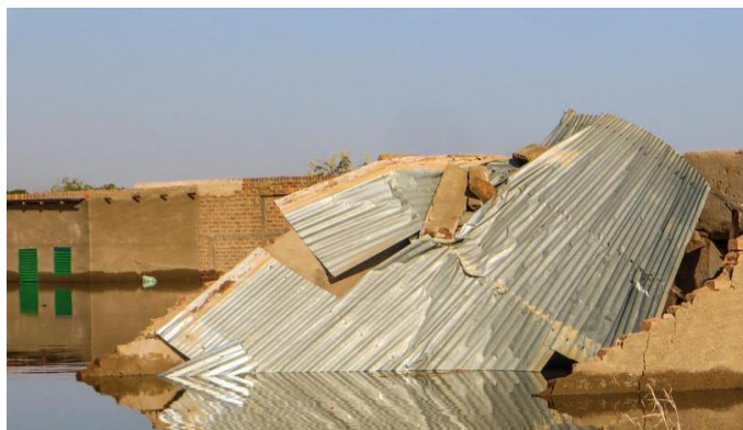
Photo 3. Délabrement d'un toit d'une maison à Pikine après la pluie
