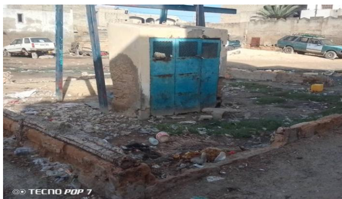
Photo 9. Etat de dégradation des stations de pompage des eaux pluviales de Pikine
