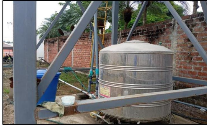
Fig. 1. Sistema actual en el urbanismo, denominado “Ablandador del agua”, con resinas
