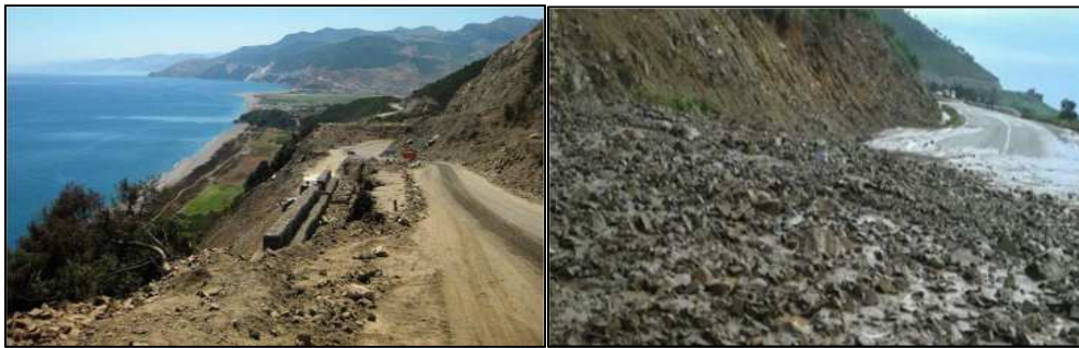
Fig. 1. Dégradation des routes marocaines par les instabilités de terrain (La rocade méditerranéenne)
