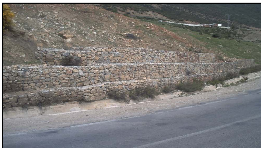
Fig. 8. L'utilisation des gabions au pied de montagne à Bab Taza
