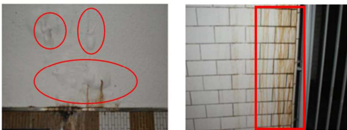
Fig. 1. Traces infiltrations observées sur les parois du tunnel de la station "cité" en juillet 2013
