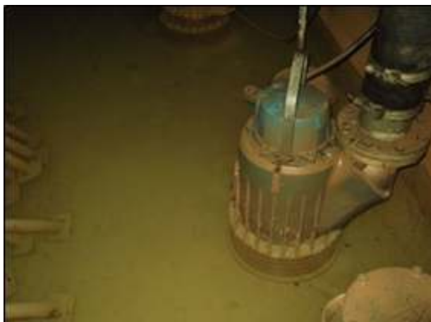
Fig. 3. Eau d'infiltration pompée à la station "Cité" à partir d'une cuvette en juin 2013
